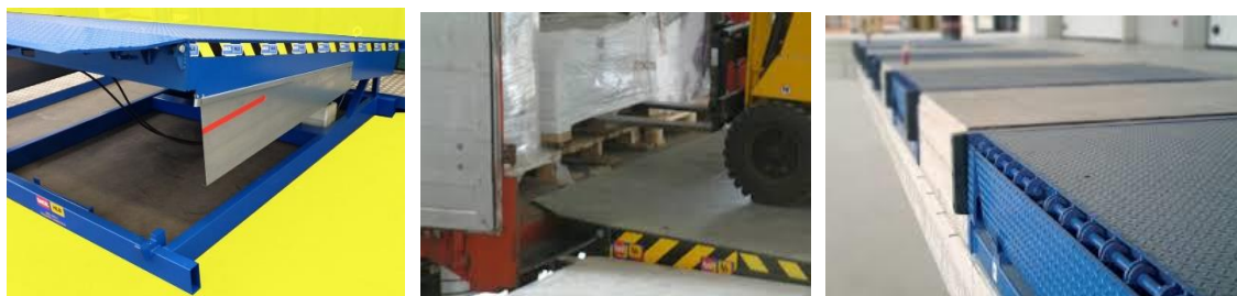
Rischio di tranciamento arti inferiori al momento dell'abbassamento della pedana. Sarà necessario inserire un parapetto con pannello (fermapiede) di altezza sufficiente ad eliminare il pericolo
